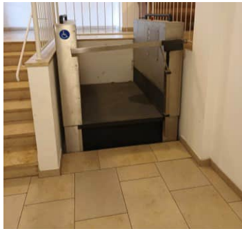
Hublift im Innenbereich
